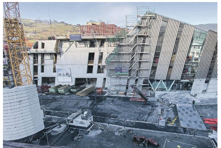
November 2020: Die Shoperweiterung wächst in die Höhe - schon lässt sich die spätere Dimension erahnen. Fotos (3): Maximilian Bründl
